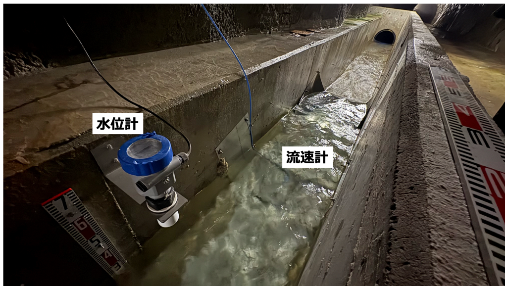
図 51: KAGRA Y-arm (Y-end) 付近の流量計設置の様子 排水路に設置された水位計と流速計が確認できる。
